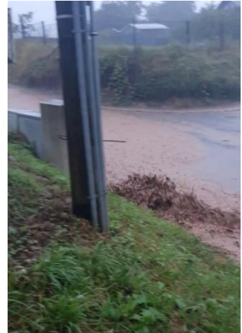
Abbildung 81: Überlasteter Straßeneinlauf bei Starkregen
